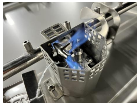
Figure 9.2 - Couverture de la flamme pilote du thermocouple.
